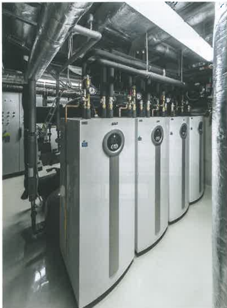
▼ Strojovna technologií s kaskádou tepelných čerpadel v popředí (foto: Tomáš Malý)
